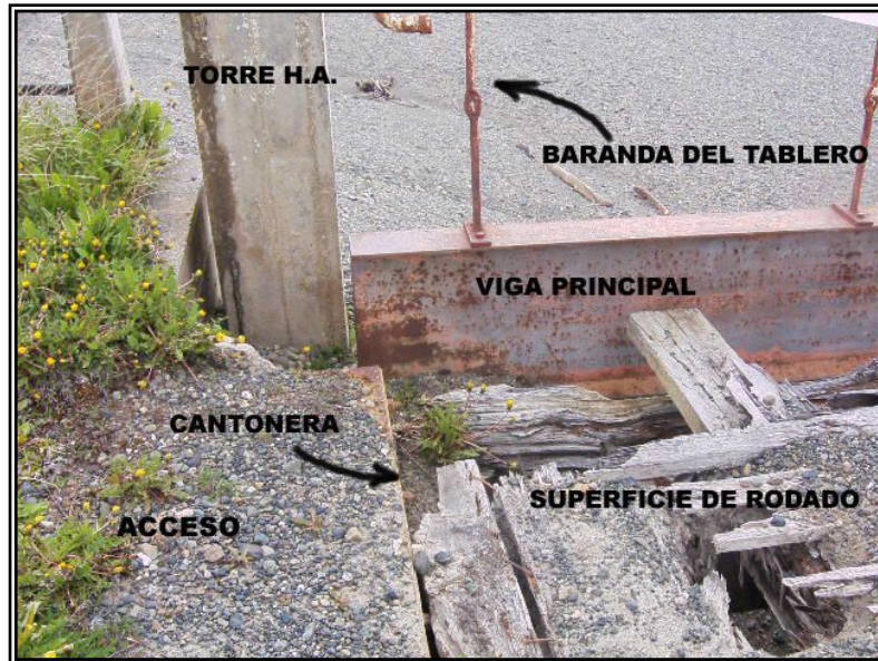
Figura 2.6. Fotografía que muestra el acceso norte, la base de la torre de hormigón armado, la cantonera, la baranda, la superficie de rodado y parte de la viga principal.
